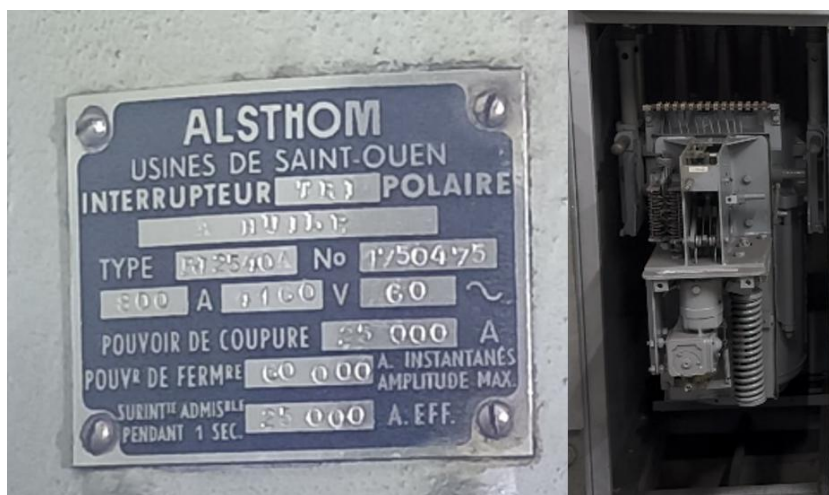
Placa de características del disyuntor
