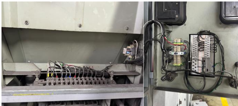
Conexiones de control del disyuntor y del relé
