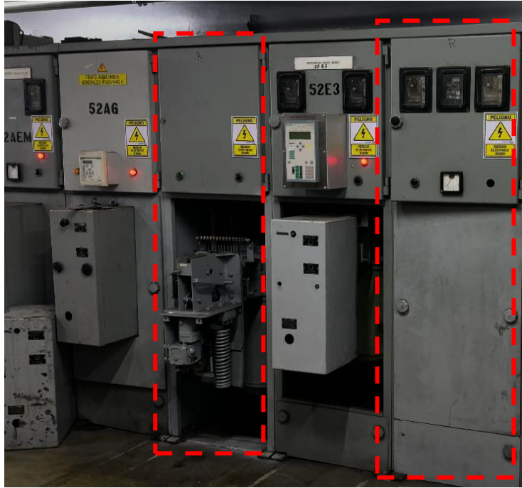
Celdas adyacentes a la 52E3 disponibles para instalar remonte
