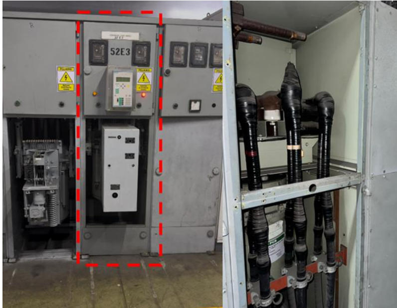
Frente de la celda y parte posterior con conexiones de potencia
