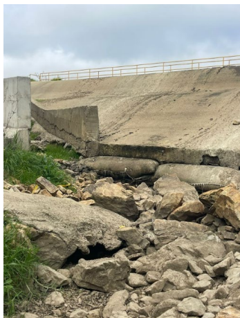
Fotografía 3. Socavación en vertedero
