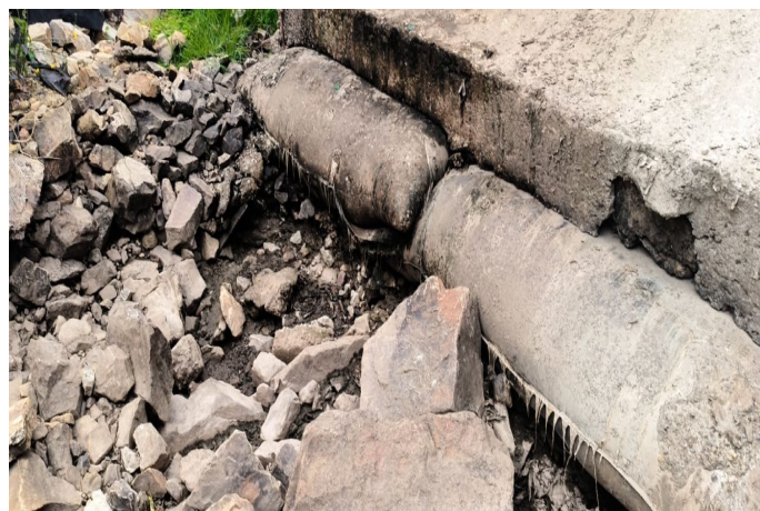
Fotografía 4. Socavación en vertedero de emergencia
