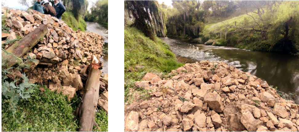
Fotografía 5. Erosión de piedra en río
