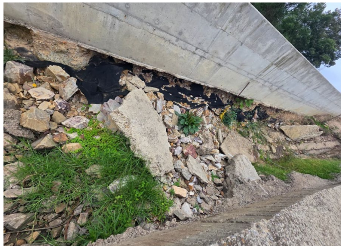
Fotografía 2. Socavación estructura canal
